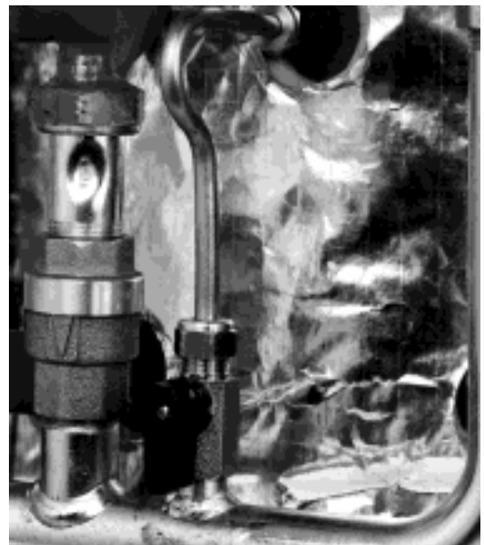
Фото А: Кран заполнения
